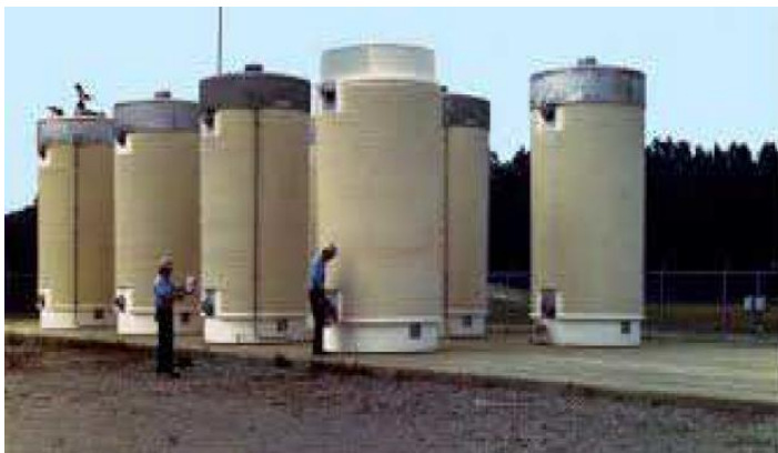
Acht thermische Speicher mit geschmolzenem Salz in der Größe 6m x 2,4m speichern 30 MWh Energie
